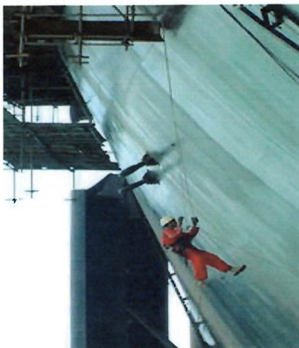
Fig. 7- Exemplo de ponto de conexão em costado de navio
